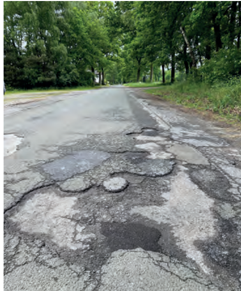
Hier besteht Handlungsbedarf
